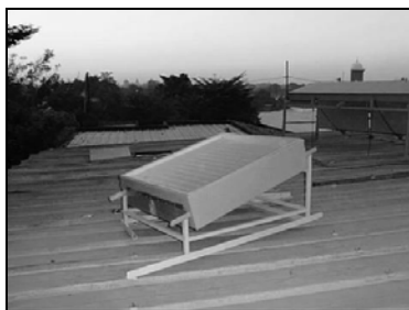
Figure 6 : Prototype construit par le CEAS-BF. Le capteur-adsorbant solaire (1m 2 ) se trouve sur la toiture et l'enceinte frigorifique (80 litres) est à l'intérieur du bâtiment
